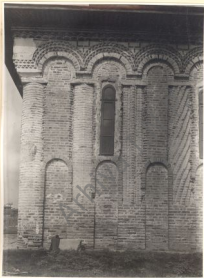
1. Lăcaș sud a pronaosului, după ivirea crăpăturilor
