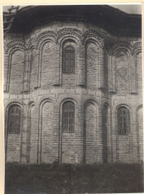
1. Absida sud, după ivirea crăpăturilor
