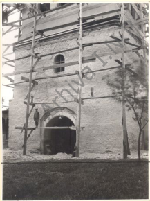
1. Fațada spre curte în timpul lucrărilor de restaurare din 1939 Se vede sidăria de umplutură din ușa etajului și forna originală a ferestrei micșorate în timpul restaurării terminată în 1910.
