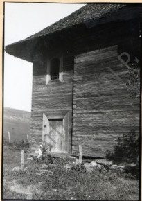
1. Detaliu. Latura sud a pronaosului cu apa de intrare și ferestra Căfasului.
