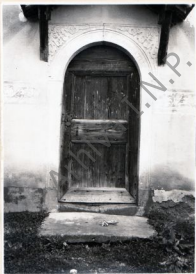
(6) (1277) Ușă de piatră sculptată a pronaosului, pe latura sud a bisericii, după restaurarea din 1928
